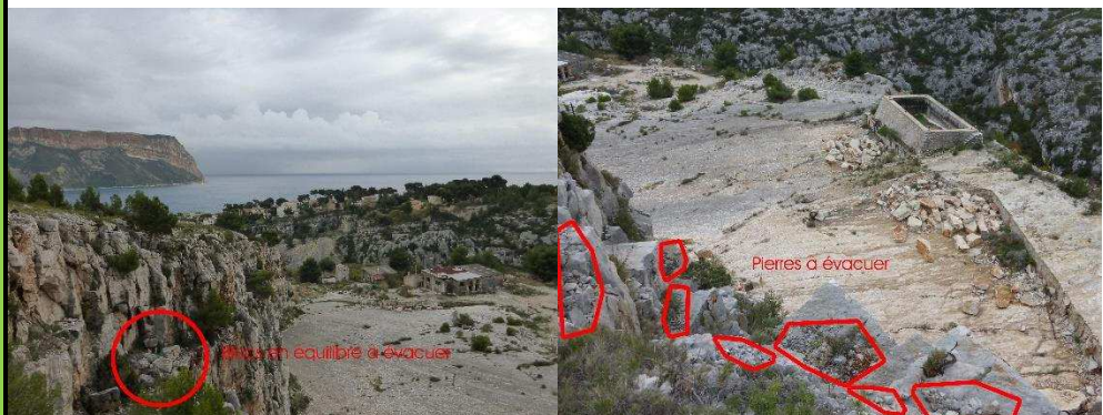
Exemple de blocs en équilibre à enlever lors de l'opération de purge manuelle (Source : Cabinet 331 CORNICHE ARCHITECTES)
